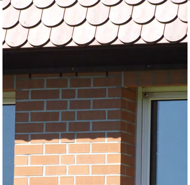
Abb. 7: Kotspuren von Vögeln an Dachverkleidung und Spalten im Mauerwerk.
