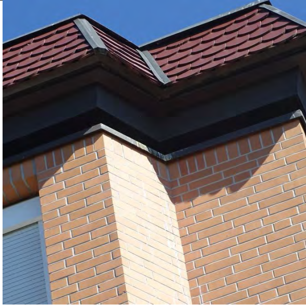
Abb. 6: Kotspuren von Vögeln an der Dachverkleidung.
