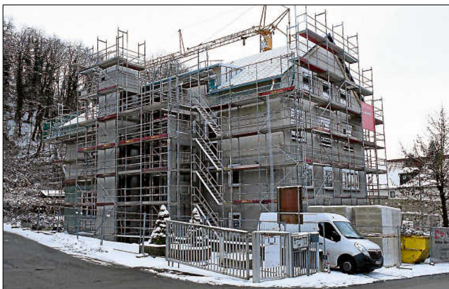
Das künftige Domizil der Stadtwerke und des Tiefbauamts soll barrierefrei werden. An der Gebäuderückseite befindet sich der Aufzugsschacht (links im Bild).
