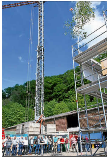
Beim Richtfest des neuen Büro- und Sozialgebäudes auf dem Gelände des Bauhofs.
