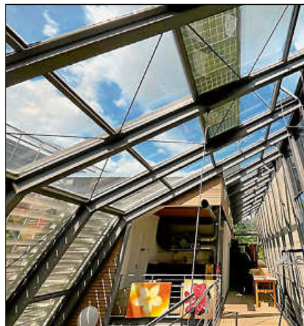
Das Glasdach über dem Foyer und dem Treppenhaus heizt den Bereich darunter stark auf.
