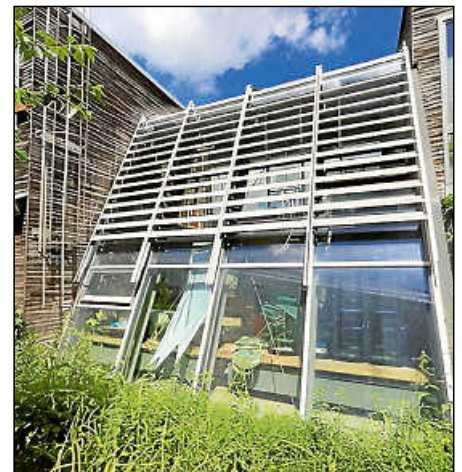
Das Dach und die Südseite mit der Verblendung sollen nun Fenster mit Solarzellen bekommen.
